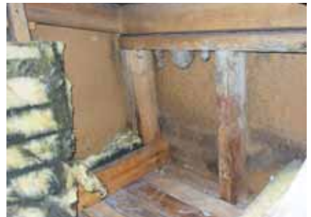
Vesikaton alustan huono tuuletus ja puutteet yläpohjan höyrysulussa voivat johtaa kattorakenteiden homevaurioihin.
