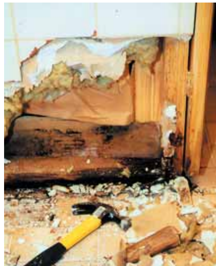
Suihkutilan vesieristeiden vuoto voi aiheuttaa homevaurion runkorakenteissa.
