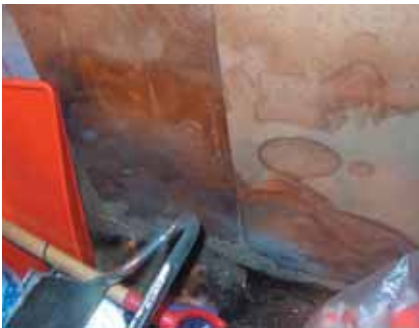
Salaojien tukkeutuminen voi aiheuttaa homevauriot kellarin seinärakenteissa.
