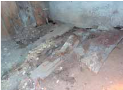
Riittämätön tuuletus ja orgaaninen jäte alapohjassa voi johtaa homeongelmaan ja jopa lahovaurioihin.
