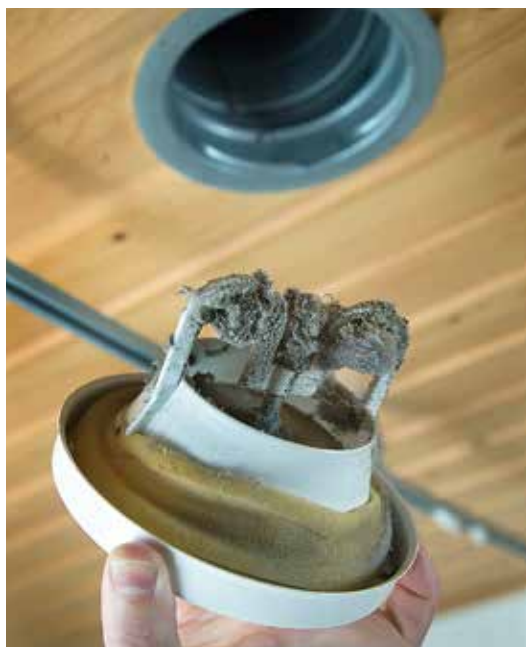
Dammiga ventiler försämrar ventilationen och därför ska man se till att de är rengjorda.
