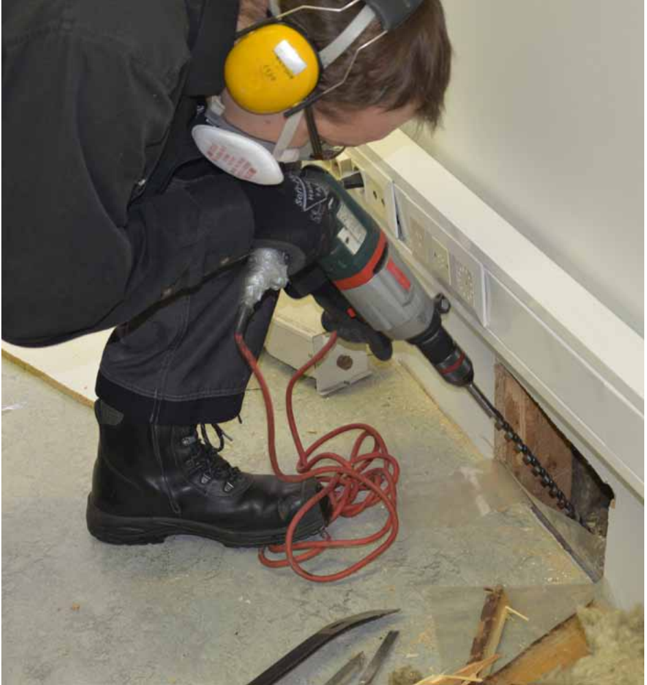
Kosteus- ja homevaurioita tutkittaessa joudutaan usein avaamaan talon rakenteita, jotta vaurio voidaan paikallistaa.
